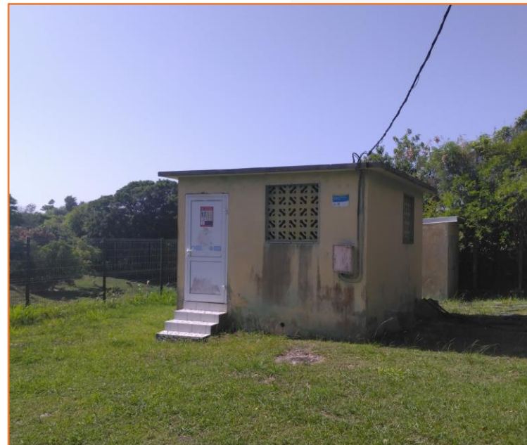
Station de pompage des Calebassiers (@BRGM, 2023)
